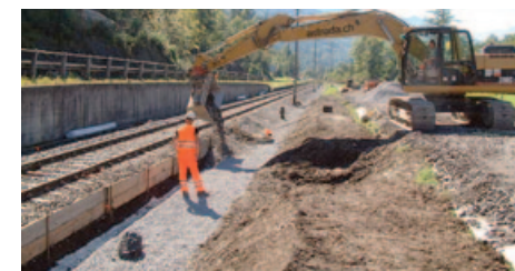
Zgodna z normami instalacja w rowie melioracyjnym
